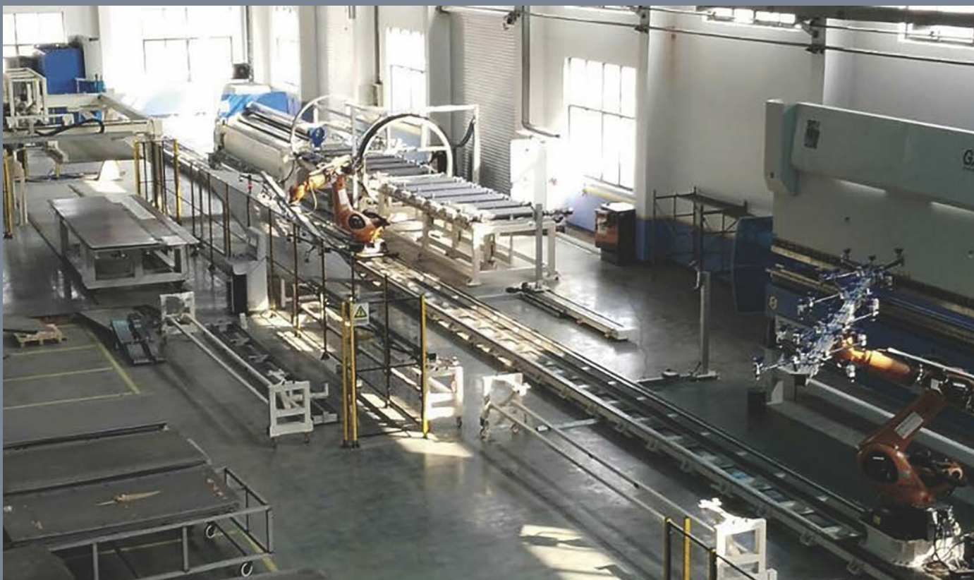
Vista impianto progettato da Sistec, nel quale 2 robot KUKA KR210 R2700 Extra sono chiamati a gestire la fase di presso piegatura dei pannelli.
